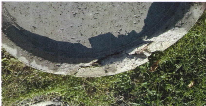
PHOTO 3. Petite fissure à l'endroit du premier couvercle de la fosse septique, devant être réparé.
