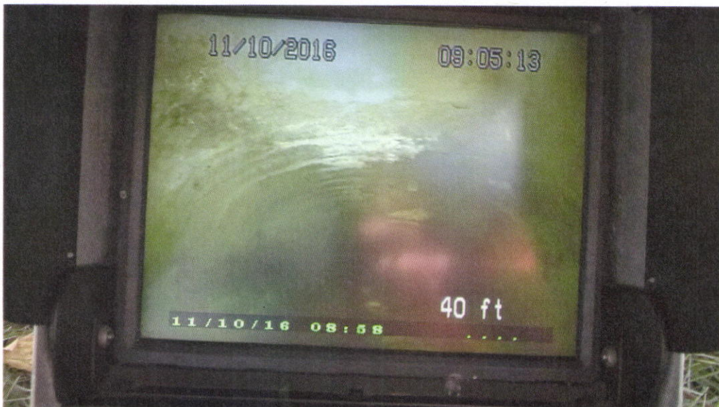
Photo 1 - Observation à 33 pieds : le tuyau est aplati
